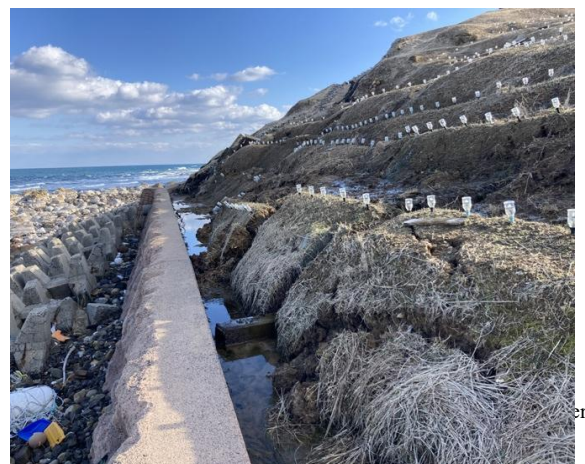
Fig.2 末端区画の圧潰状態
